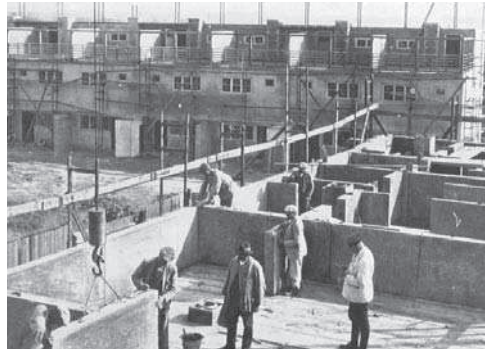
Abb. 6 (links) Bau der ersten Häuser im Plattenbauverfahren in der Straße Im Hofgut, Frankfurt-Praunheim
